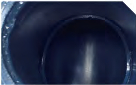
电泳管道内壁
